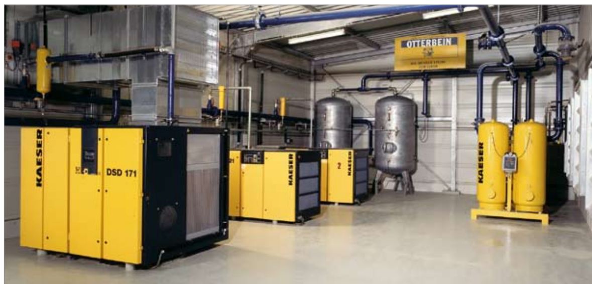
Центральная компрессорная станция спроектирована с учетом расширения
